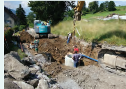
Um zu verhindern, dass Oberflächengewässer und das Grundwasser nicht durch Abwasser verunreinigt werden, ist die laufende Instandhaltung und technische Weiterentwicklung des Kanalsystems und der Abwasserreinigungsanlage unerlässlich.
