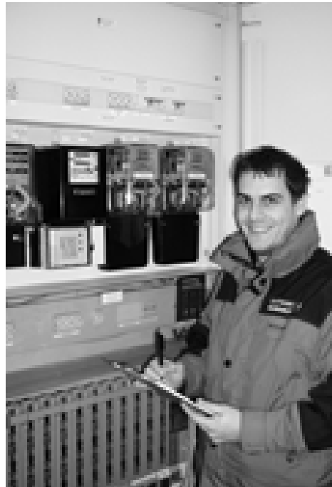
Mindestens einmal pro Monat wird der Verbrauch an Wärme, Strom und Wasser bei mittlerweile 25 städtischen Gebäuden in ganz Feldkirch abgelesen.
