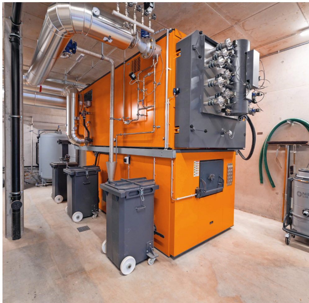
< Die Biomasse-Kesselanlage im neuen Heizwerk der Stadtwerke.
